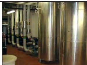
Stockage van het warme water voor het sanitair
